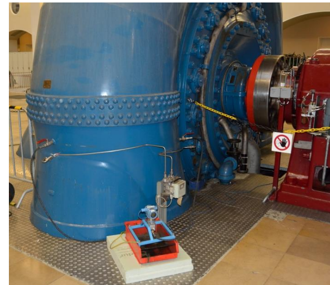
Indexmessung: Kraftwerk Reischach Francis mit 34 MW
